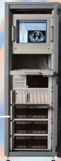
Baie Getek pour serveurs et unités de stockage
